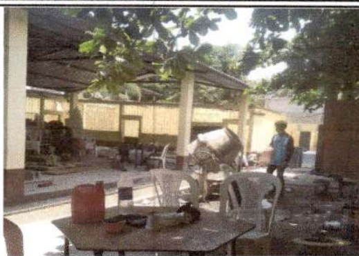
Foto 2: Torta de cemento en area de patio
